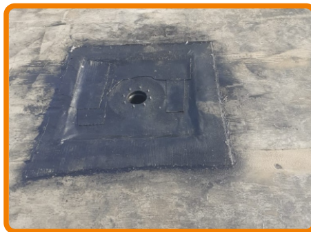
Водосточная воронка со слоем усиления 1000*1000 мм, уровень воронки понизить относительно основного уровня кровли на 20–30 мм в радиусе 500 мм
